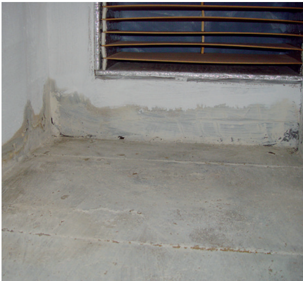
Feuchtigkeit im Keller – handelt es sich hier um Grundwasser oder um Wasser aus den verstopften Sickerleitungen?
