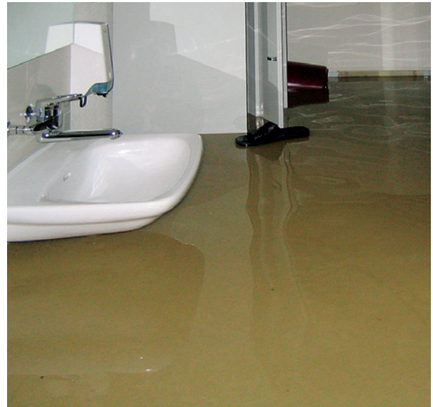
Kommt dieses Wasser von einem Rückstau aus der Kanalisation, vom nahe gelegenen Dorfbach oder handelt es sich um einen Rohrleitungsbruch?
