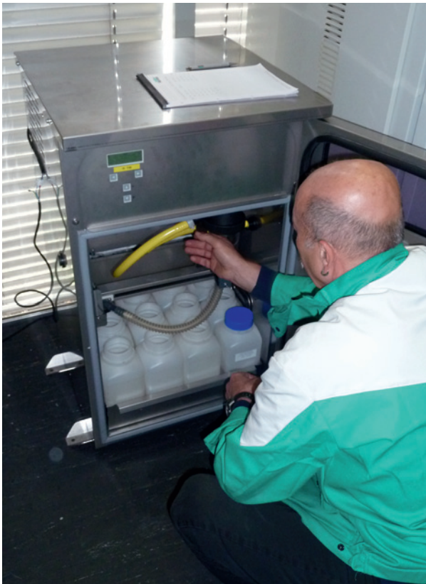
Installation des automatischen Probennehmers – das Abwasser kann vom Kanal zu diesem hinaufgepumpt werden.
